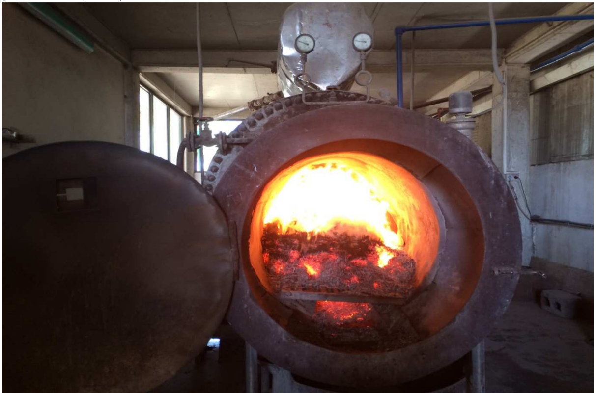
Figure 6 Boiler with fixed conveyor në fabrikën AlbKalustyan, Maminas Durrës
